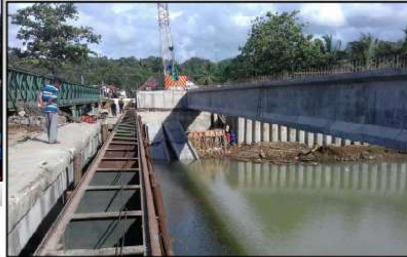
Kondisi Saat Kecelakaan Konstruksi
