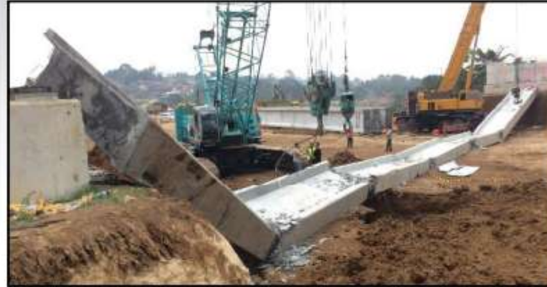
Kondisi Saat Kecelakaan Konstruksi
