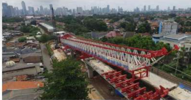
Kondisi saat Kecelakaan Konstruksi
